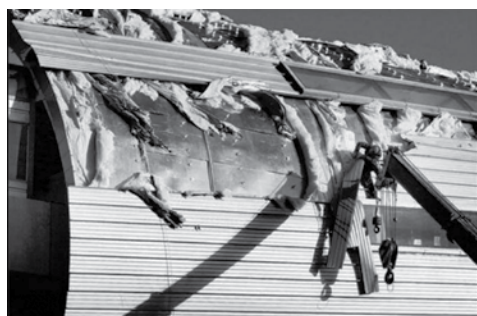
金属屋面被破坏
